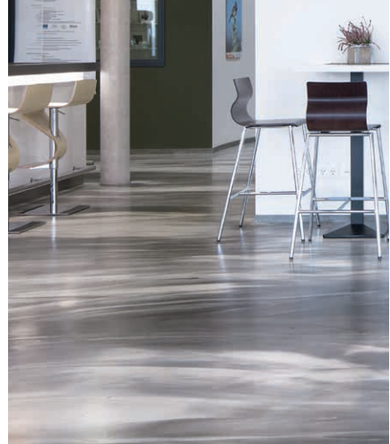
Floortec 2K-Mineralico SL 470 in kontrastreicher, zweifarbiger Ausführung (Grundfarbton 60.FM.03 mit Akzentfarbton 72.FM.18)
